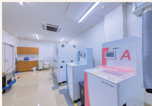
↑最新機器を揃えた機械室。右端に見えるのが換気扇ダクト
